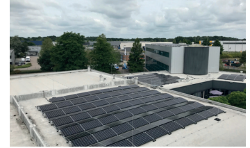
724 zonnepanelen en warmtepompen
